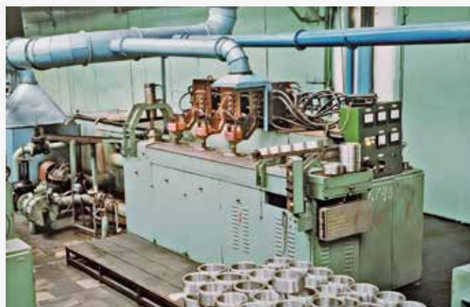
Рис. 2. Общий вид индукционной установки для объемно-поверхностной закалки колец подшипников на АО «Московский подшипник» (ГПЗ-1) [8]
